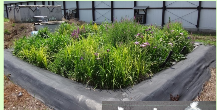
↑ 間欠鉛直流式人工湿地
