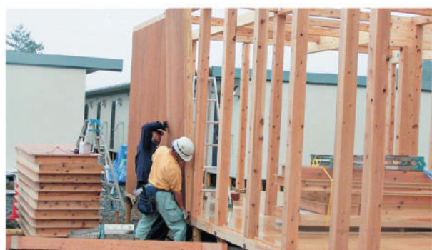
仮設集会施設の建設現場。「復興ボード」を用いた壁のパネルを施工している様子。(2011年6月13日)
